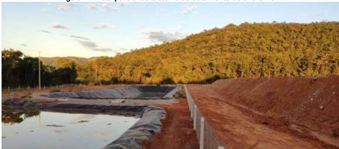
Figura 7 - Vista parcial do sistema de tratamento de chorume.
