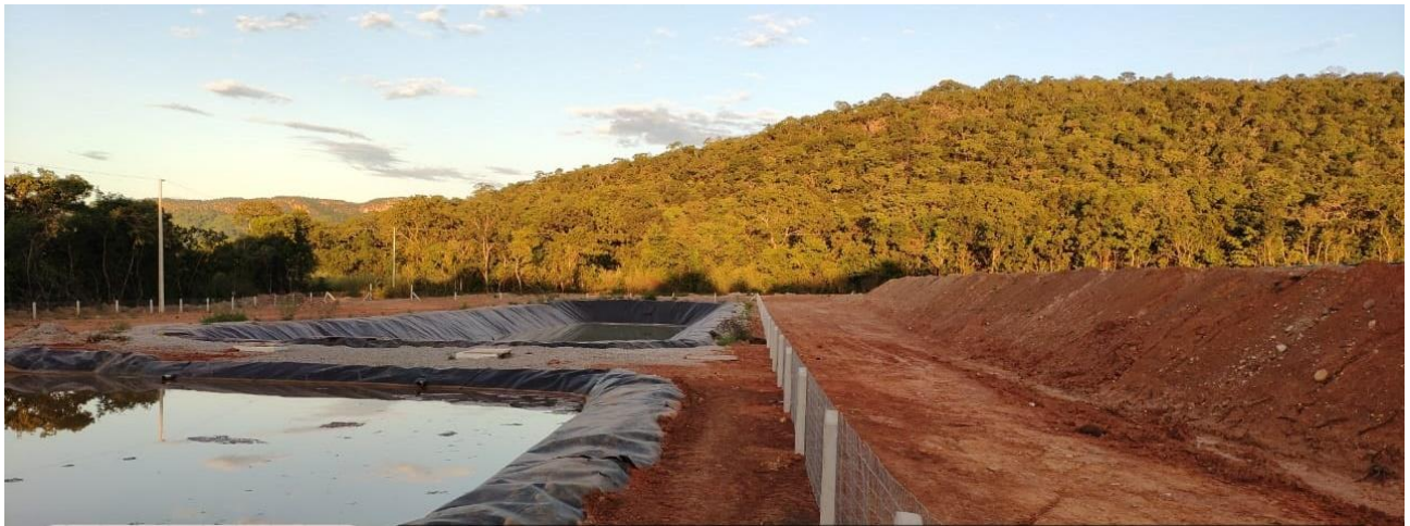
Vista parcial do sistema de tratamento de chorume
